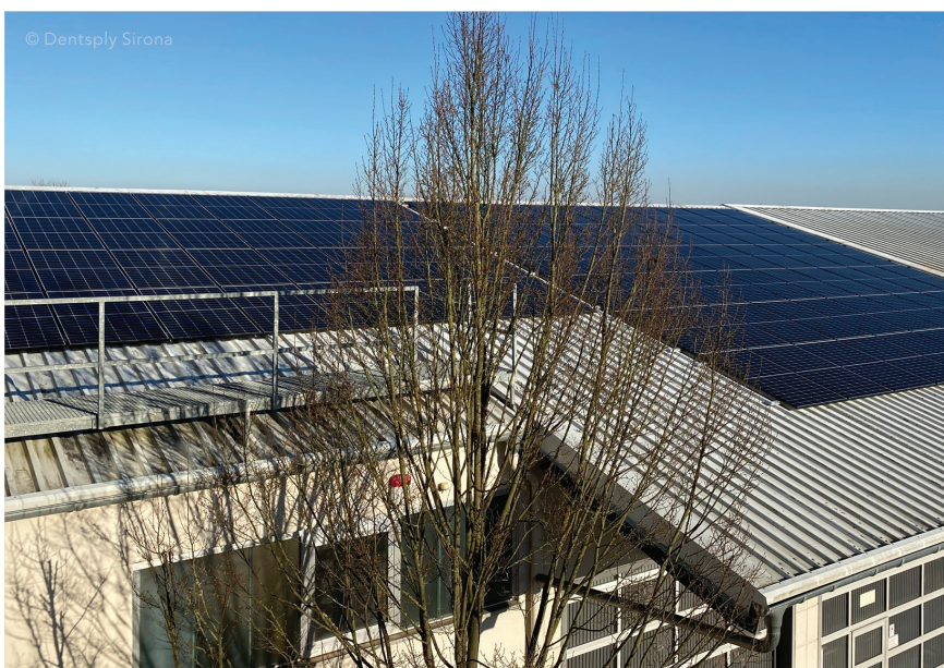
Die am Produktionsstandort von Dentsply Sirona in Elz (Deutschland) installierten Solarzellen können bis zu 13,6 Tonnen CO 2 pro Jahr einsparen.
