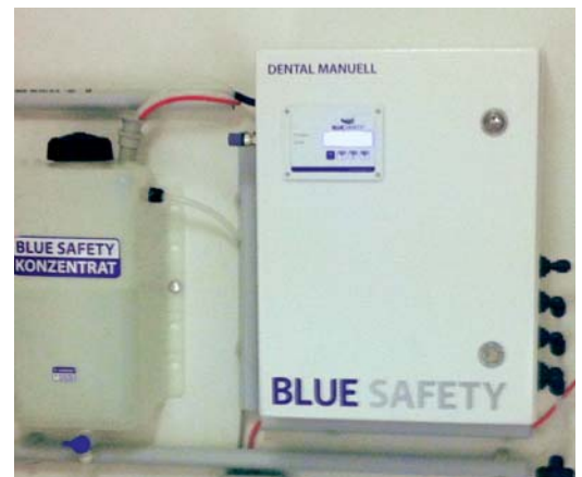
Ausschnitt BLUE SAFETY Installation
