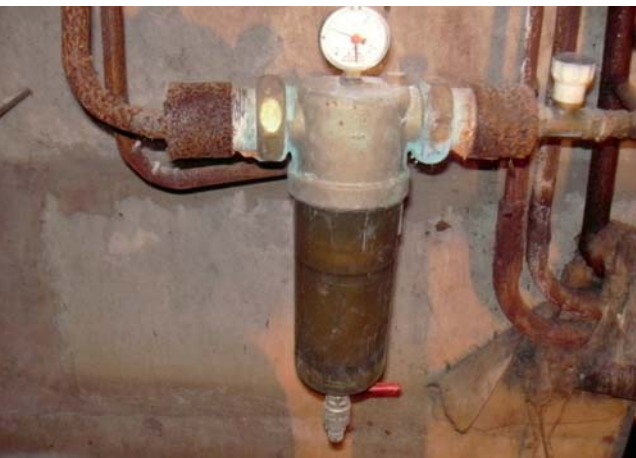
Verschmutzte Filter stellen eine Ursache der Wasserkontamination dar.
