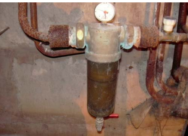
Verschmutzte Filter stellen eine Ursache der Wasserkontamination dar.
