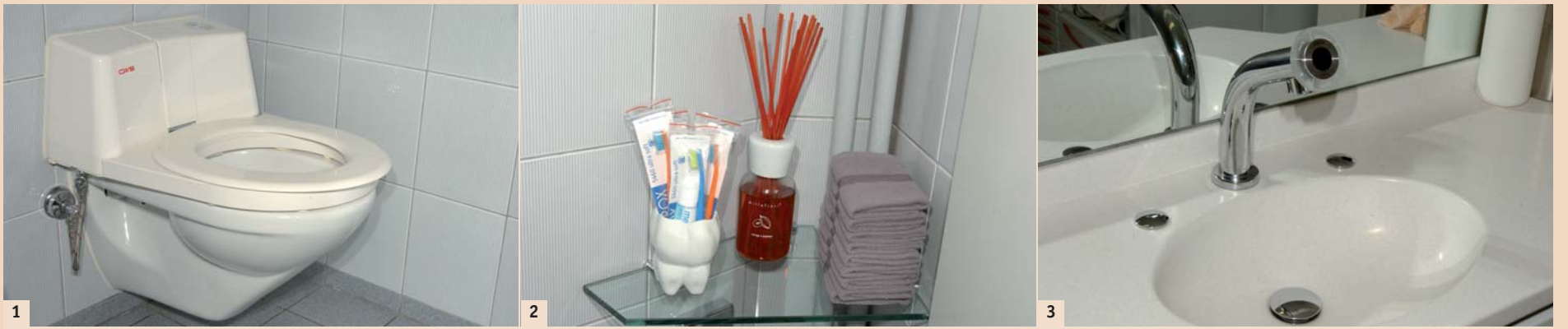
Abb. 1: Selbstdesinfizierendes Toilettensystem: CWS. – Abb. 2: Zahnbürsten, Raumduft-Dispenser und wiederaufbereitbare Handtücher in der Patiententoilette. – Abb. 3: miscea-Multifunktionspender am Waschbecken.
