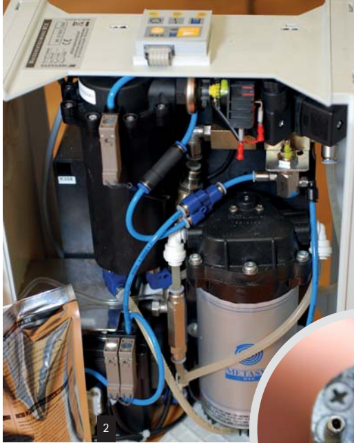
Abb. 2: Freier Auslauf gemäß DIN EN 1717. – Abb. 3: Biofilm und Kalkablagerungen an der Luft-Wasser-Spritze.
