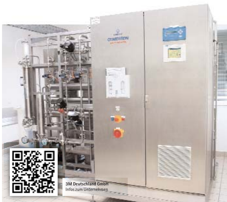
Abb. 1: In dieser Anlage wird das Wasser für pharmazeutische Zwecke aufbereitet.
