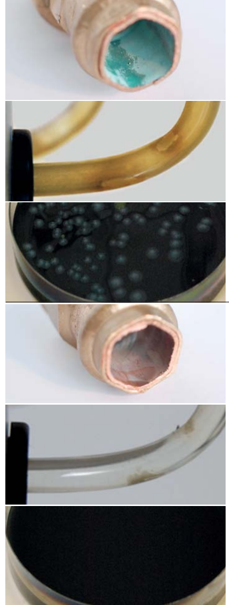
Biofilm in Hausinstallationen.
