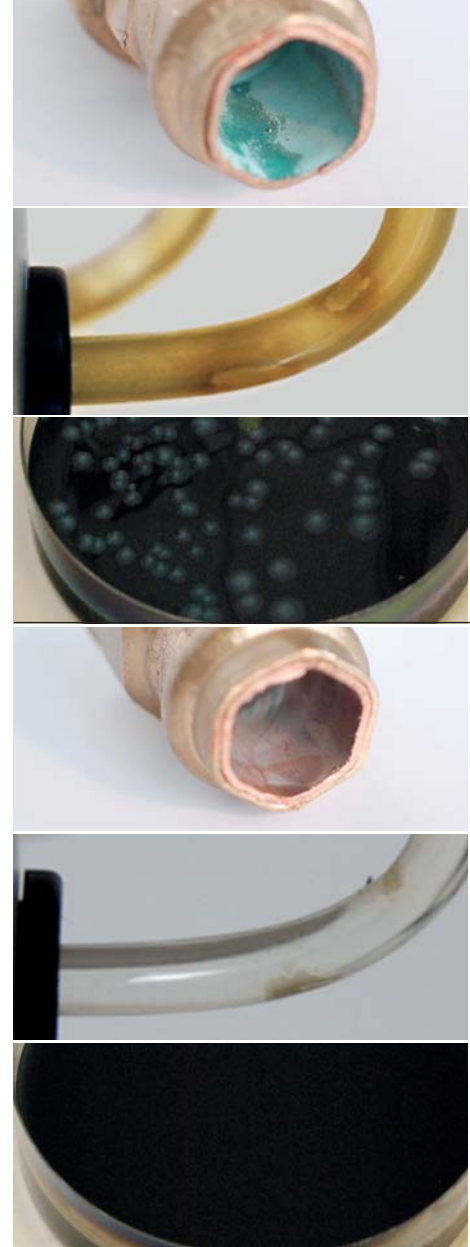
Biofilm in Hausinstallationen.
