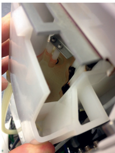
Abb. 1: Freie Fallstrecke gemäß DIN EN 1717 in Dentaleinheit (Weißer Behälter mit schwarzem Pilzbewuchs).
