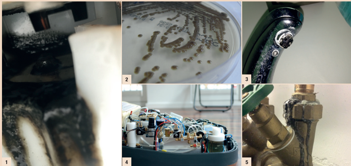
Abb. 1: Exophiala -Befall in freier Fallstrecke gem. DIN EN 1717. - Abb. 2: Exophiala -Kultur in Petrischale. - Abb. 3: Exophiala -Befall von Strahlregler an Armatur. - Abb. 4: Komplexes Schlauchsystem aus Kunststoff einer Behandlungseinheit. - Abb. 5: Exophiala -Befall einer Trinkwasserinstallation in einer Zahnarztpraxis. - Abb. 6: BLUE SAFETY SAFE BOTTLE System.
