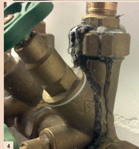
Abb. 3: Exophiala-Befall von Strahlregler an Armatur. - Abb. 4: Exophiala-Befall einer Trinkwasserinstallation in einer Zahnarztpraxis.
