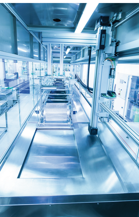
Die vollautomatische Waschstraße im firmeneigenen Reinraum.
