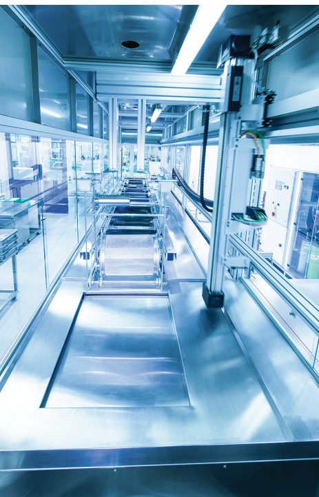
Die vollautomatische Waschstraße im firmeneigenen Reinraum.
