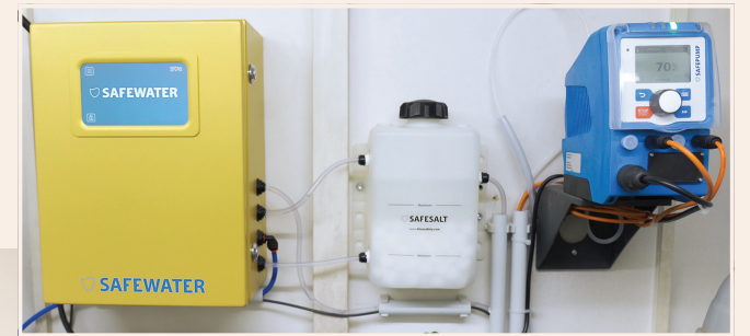
Zentral implementiert versorgt SAFEWATER sämtliche Entnahmestellen der Trinkwasserinstallation der Praxis.
