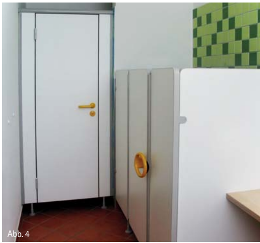
Abb. 4 bis 6: Der Aspekt „das Kind steht im Mittelpunkt“ wird auch auf der Patiententoilette deutlich, wenn eine eigene kleine Kindertoilette mit Kinderwaschbecken eingebaut ist. Ebenso darf ein Wickeltisch nicht fehlen. Dieser kann auch seitens der Anästhesie zur gelegentlich notwendigen rektalen Gabe von Dormicum genutzt werden.
